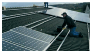
Photovoltaikanlage bei der Firma Berghaus
